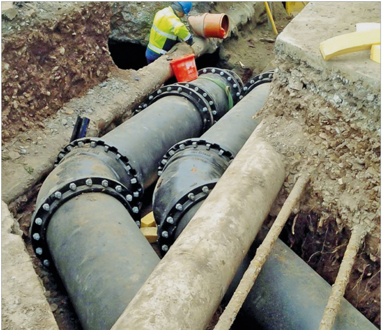
DUCPUR Doppelleitung DN 700 mit Vor- und Rücklauf.
