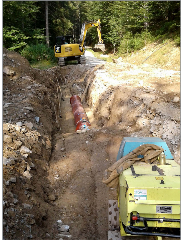
Nach dem Einbau der duktilen Gussrohre entlang eines Forstwegs wird das Verfüllmaterial lagenweise verdichtet.
