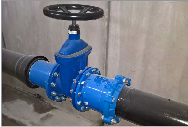
Absperrarmatur vom Typ vonRoll VS 5000 im Werkleitungskanal
