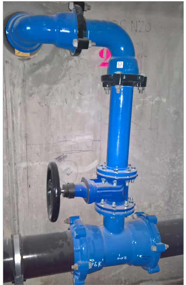
Seitlicher Abgang zu den Hydranten-Nischen mit ECOFIT-Formstücken
