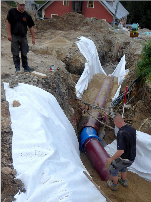
Richtungsänderung der Kraftwerksleitung von 30° in Seebachschleife mit einem Formstück, MK 500/30° und BLS®-Muffen-Verbindungen, ausgekleidet und umhüllt mit Epoxi-blau
