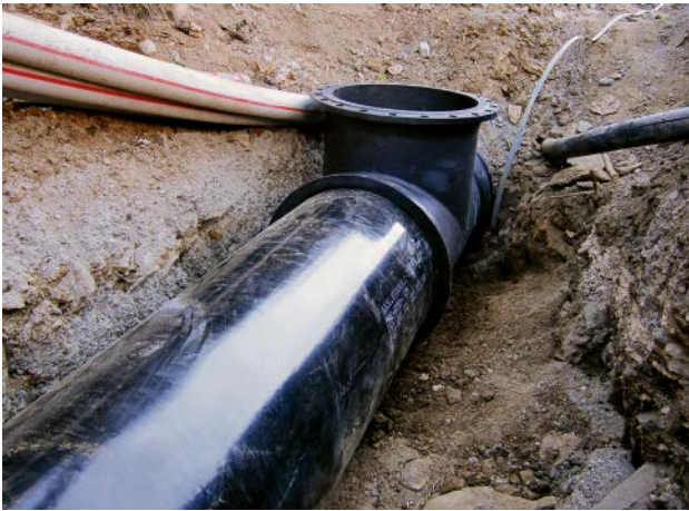
Bild 2: Mannloch für Unterhalt und Revisionsarbeiten im Bau, ausgebildet mit MMA-Stück DN 600/600, mit Epoxidharz beschichtet. Im Endausbau mit Blindflansch DN 600 inkl. Leitblech ausgerüstet
