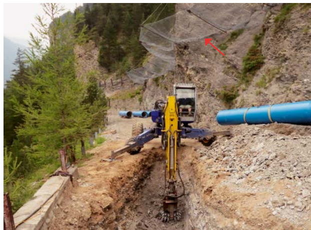
Bild 5: Steinschlagschutzmaßnahmen entlang der Rohrleitungstrasse
