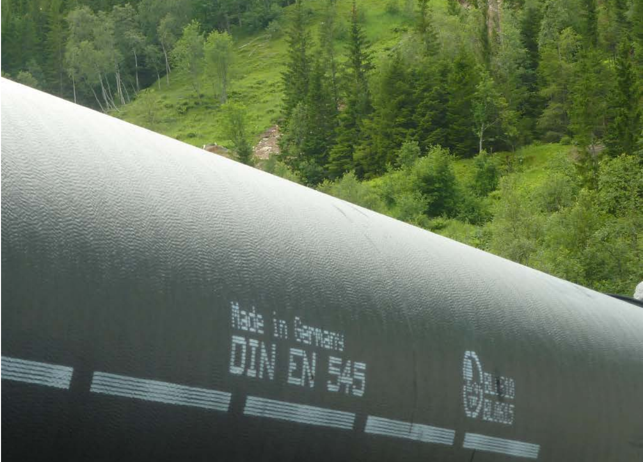
Bild 9: Duktiles Gussrohr im Rohrlager von Tverraga
