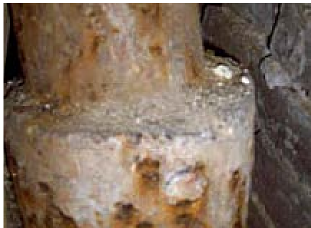
Bild 2: Muffen-Verbindung einer im Oktogon eingebauten Gussrohrleitung
