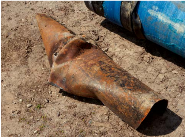
Bild 9: Aufgefaltetes Stahlrohr (Vordergrund) – leichte Kratzspuren auf der Zementmörtel-Umhüllung des duktilen Gussrohres (Hintergrund) Quelle: BASF SE, Ludwigshafen
