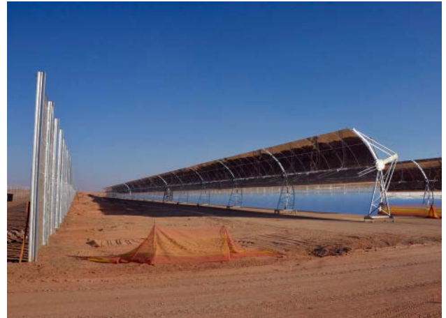
Bild 5: Fünf Meter hohe Windzäune schützen die Parabol- spiegel vor starken Winden
