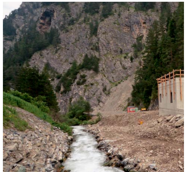
Bild 4: Doppelkammer-Entsander am Fassungsbauwerk
