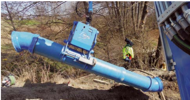
Bild 5: Einheben einer Rohr-Etage in den Rohrgraben mit dem innovativen Einbausystem für duktile Gussrohre
