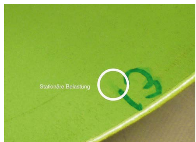
Bild 1: Einwandfreie PUR-Auskleidung nach der Prüfung zur Ermittlung der Hochdruckstrahlbeständigkeit durch das IRO, Oldenburg: Innenbeschichtung nach stationärer Belastung
