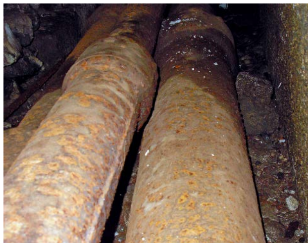
Bild 3: In Betrieb befindliche Gussrohrleitung im Oktogon
