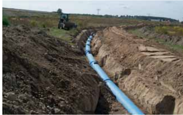
Bild 5: Duktile Trinkwasserleitung DN 600 im Bereich Kienberg
