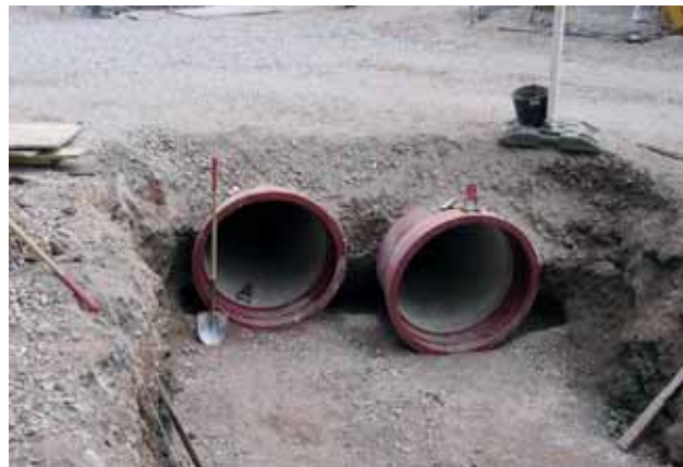
Bild 7: Erdüberdeckter Entlastungskanal (Doppelleitung DN 1000)
