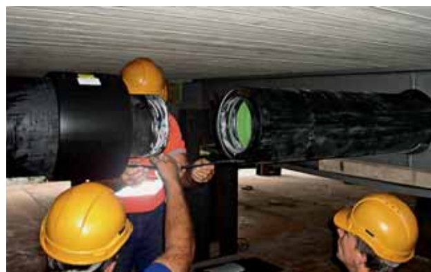
Bild 4: Das ecopur-Rohr aus duktilem Gusseisen mit innenliegender Schubsicherung wird für den Zusammenbau der Steckmuffen-Verbindung vorbereitet.
