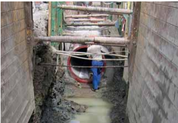
Bild 5: Ablaufkanal DN 1400 vom Regenüberlaufbecken
