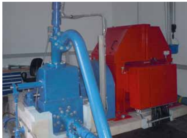
Bild 5: Turbine und Generator
