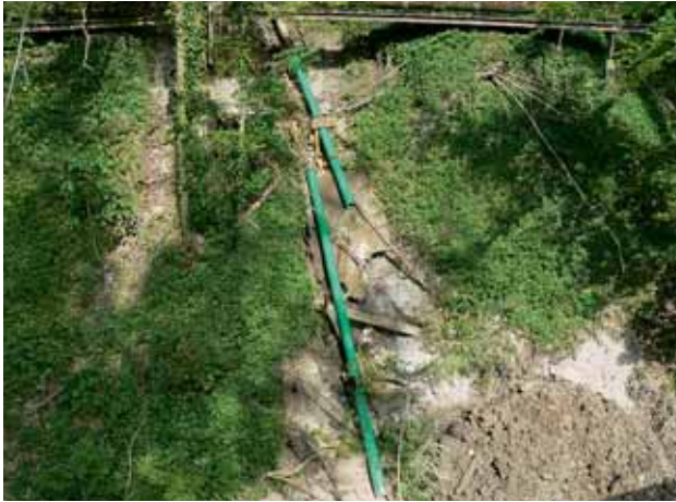
Bild 2: Destabilisierte, abgerutschte Fundamente
