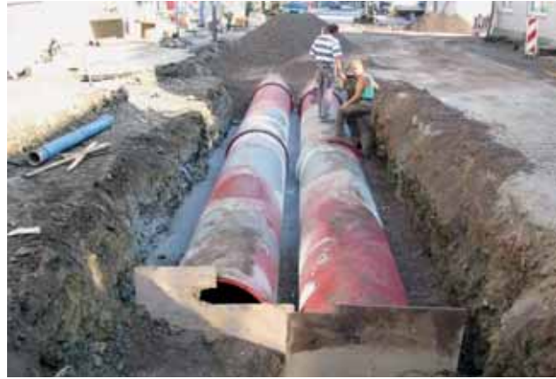
Bild 6: Entlastungskanal des Regenüberlaufbauwerkes als Doppelleitung aus duktilen Gussrohren DN 1000
