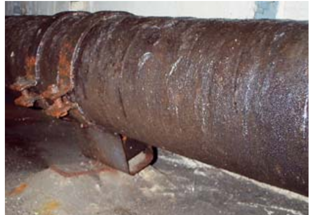
Bild 2: Zustand der Altleitung
