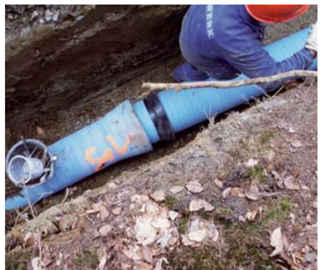
Bild 7: Bergwärts gerichtete Muffe der Steilhangleitung
