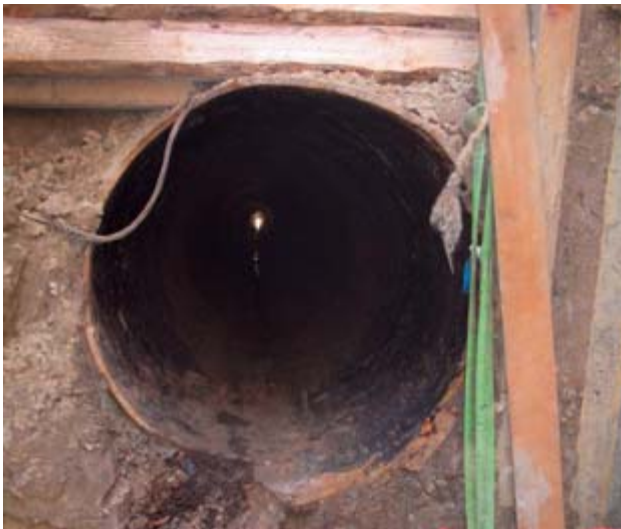
Bild 5: Altleitung nach Reinigung
