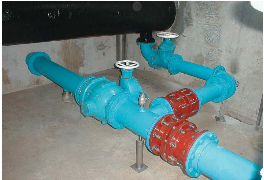
Bild 7 Spülschacht mit Kugelhahn
