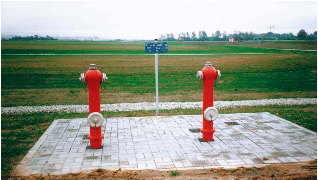
Bild 3 Flugfeld mit Oberflurhydranten
