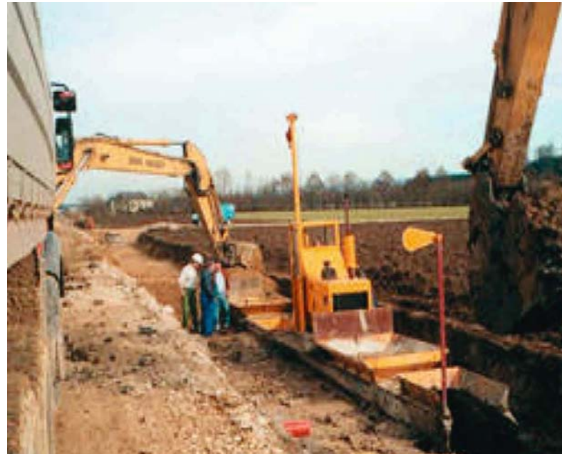
Bild 4 Führerstand auf dem Rohrkasten
