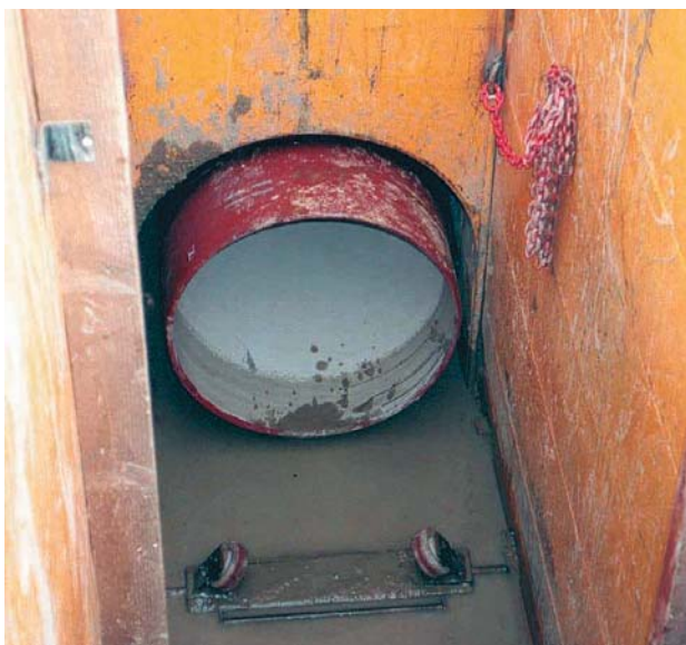
Bild 3 duktiles Gussrohr DN 600 im Rohrkasten des PLR
