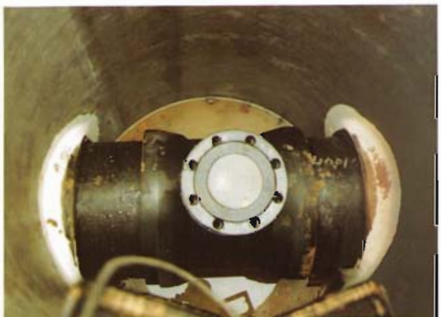
Bild 4: Blick in einen vorgefertigten Schacht: In der Mitte das MMA-Stück mit geschlossener Putzöffnung; in den beidseitigen Schachtwänden die eingearbeiteten Dichtungen zur wasserdichten Rohreinführung
