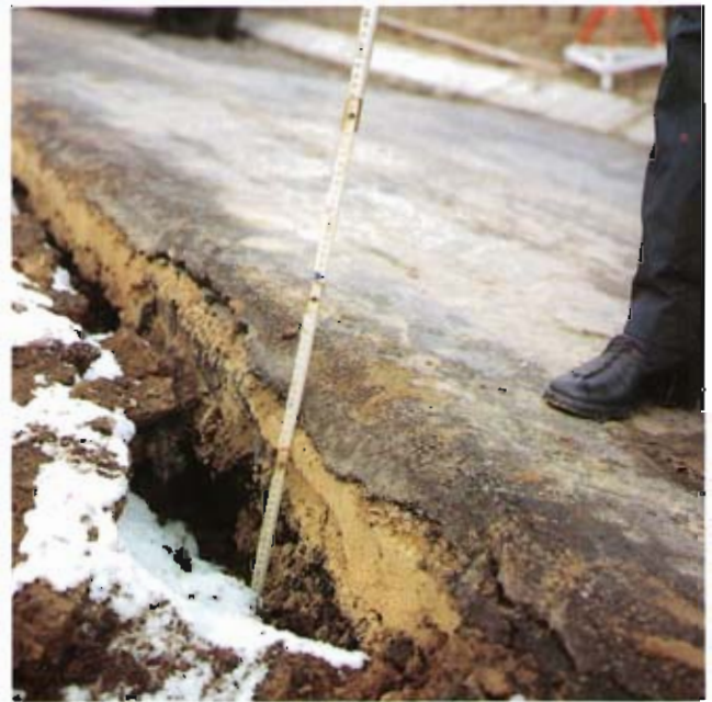
Bild 5: Erdoberfläche mit bis zu 15 cm breiten Rissen
