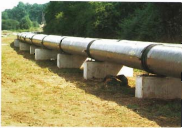
Bild 10: Auf Betonaufgaben verlegte Leitung
