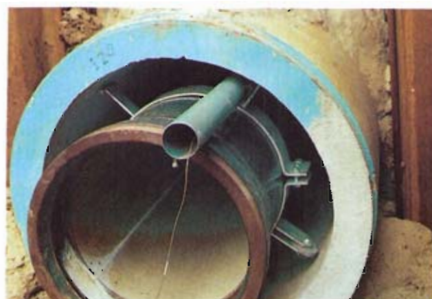
Bild 5: Detailaufnahme der Produktenleitung DN 700 im Preßrohr DN 1200 mit Schlitten und Leerrohr für Steuerkabel
