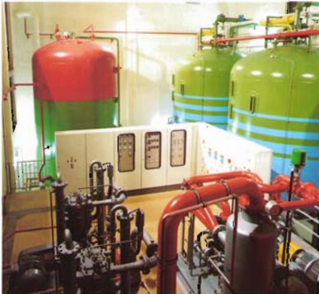
Bild 5: CARIX-Anlage: links: Reaktionsbehälter (2) (gemäß Verfahrensschema Bild 3), rechts 2 Austauschfilter (1), in der Mitte Blindschaltbild und Steuerschrank, vorne Vakuum- und Kompressorstation (9)
