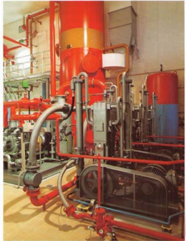
Bild 6: Vorne Verdichterstation (9), links Vakuumpumpe (9), hinten oben Vakuumentgaser (3), hinten unten CO 2 -Entgaser Reinwasser (4) (gleicher Behälter, durch Zwischenboden getrennt)
