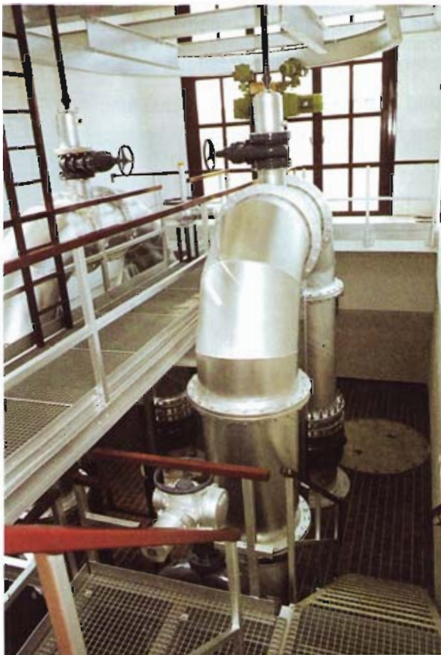
Bild 5: Leitungshochpunkt im Vereinigungsbauwerk
