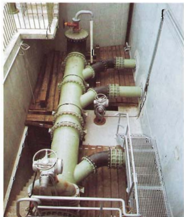
Bild 4: PW Neuer Hafen, Druckleitung
