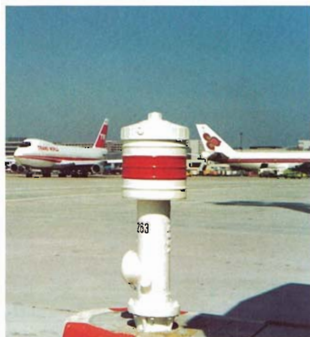
Bild 6: Überflurhydranten im Flugzeugabfertigungsbereich
