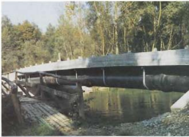
Bild 2: Rohre in Schellen an der Brücke aufgehängt
