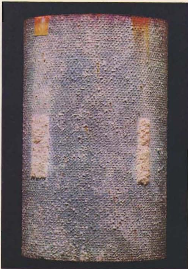
Bild 4 Rohrabschnitt mit einer Kruste von Zinkkorrosionsprodukten auf einer „Transportverletzung“
