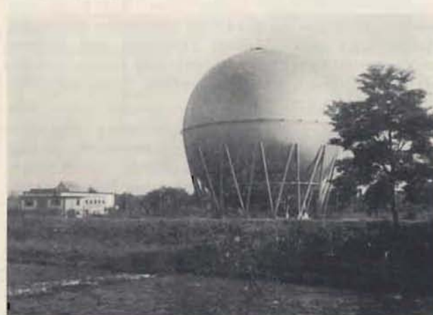
Bild 4: Kugelgasbehälter mit Gasübernahmestation
