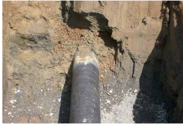
Fig. 7 Project 3: Test dig – Zweckverband Mittelhessische Wasserwerke ZMW supply utility, connection to Gladenbach, Lohra section – DN 300 ductile iron pipe, year of installation 1978/1979
