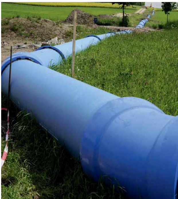
Fig. 10: A DN 600 interim pipeline used by Zweckverband Fernwasser Südsachsen
