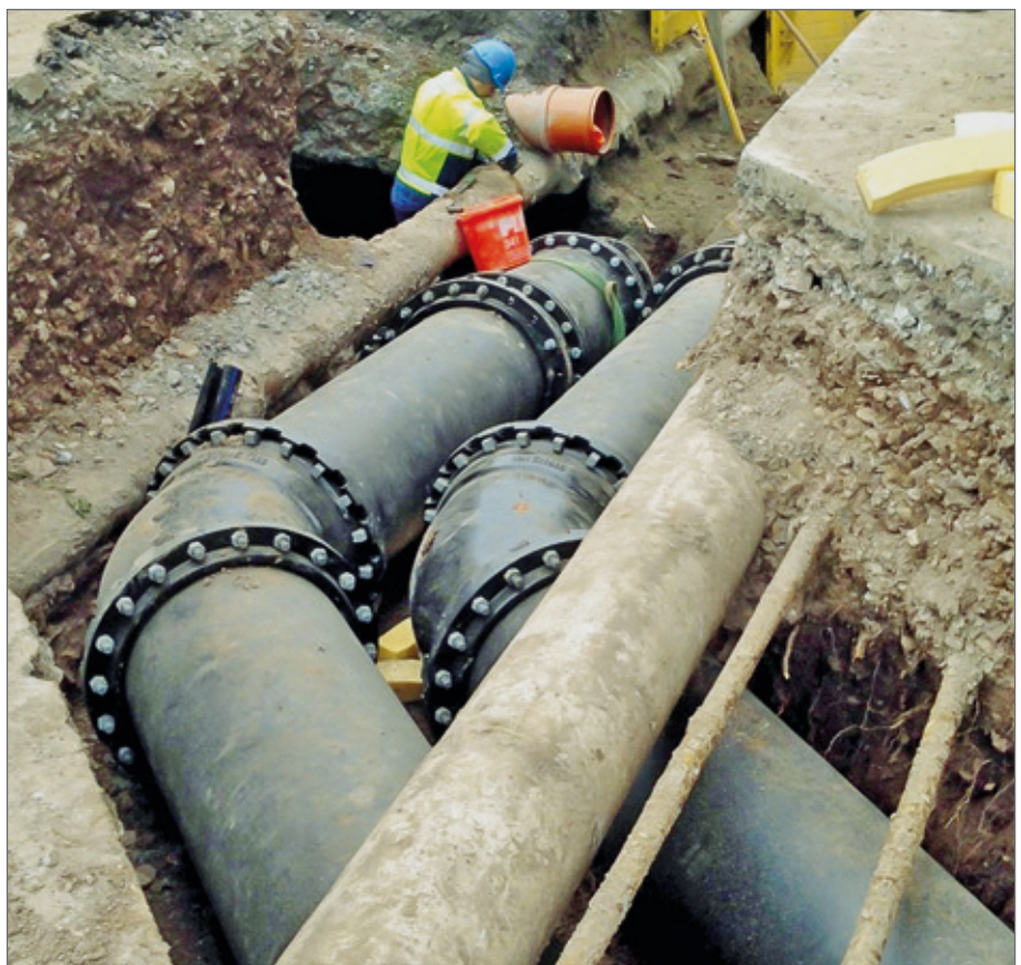
DUCPUR Doppelleitung DN 700 mit Vor- und Rücklauf.
