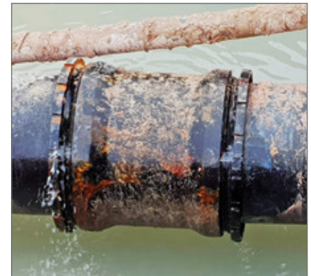
Undichte Verbindung an einem U-Stück.
