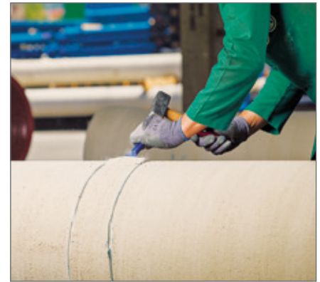
Die Zementmörtelschicht lässt sich nach dem Schnitt einfach mit Hammer und Meißel ablösen.
