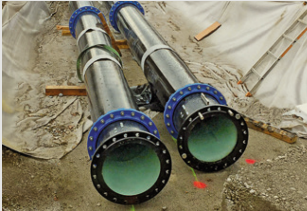
Doppelleitung ARA Werdhölzli, Zürich, DN 600, PFA 25 bar.
