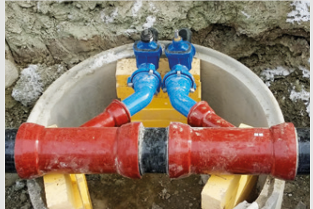
ECOPUR DN 250 mit Hauseinführung, DN 100 zum Wärmetauscher.
