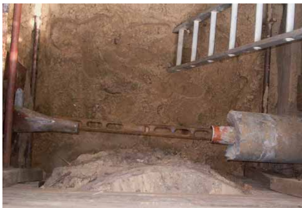
Bild 3: Zuggestänge, geführt in einem Kunststoffrohr
