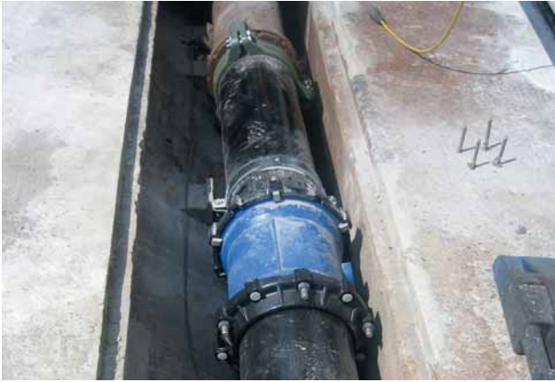
Bild 7: Zusammenschluss der ecopur -Rohre mit der bestehenden Schraubmuffenleitung auf der Seite d. Gemeinde Emmen
