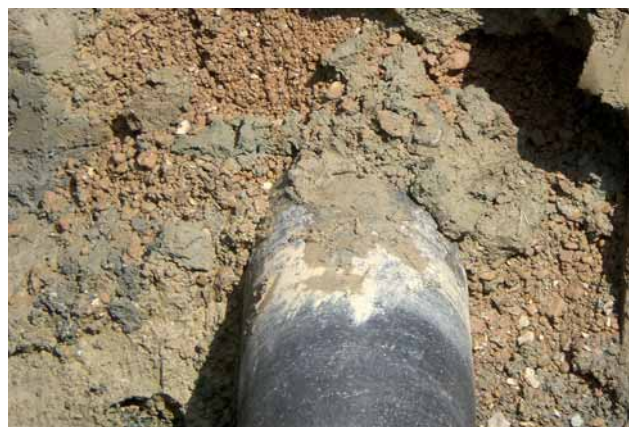
Bild 9: Projekt 3: Duktiles Gussrohr DN 300 – Boden im Sohlbereich schwach aggressiver Kies, Rohrumhüllung seitlich und oberhalb des Rohres mit stark aggressivem Boden, Grundwasser vorhanden
