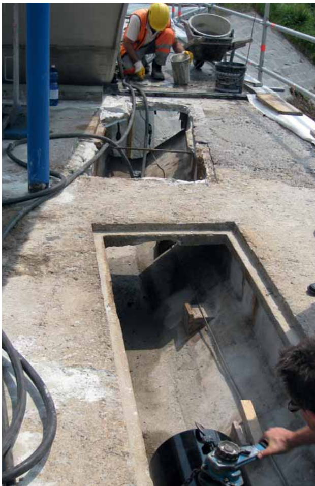
Bild 4: Kurze Montageöffnung (Länge 1,40 m) beim Betonwiderlager am Brückenrand im Anschlussbereich auf der Seite der Stadt Luzern
