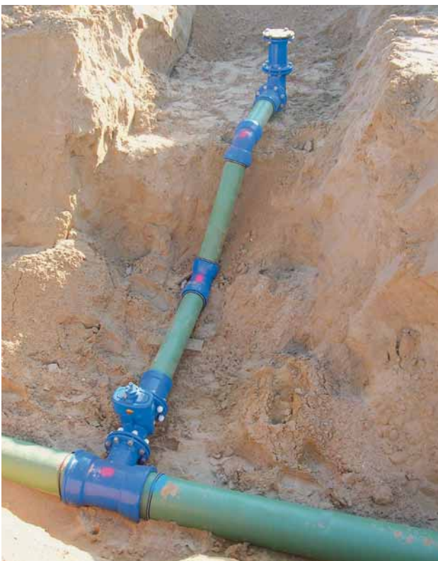
Bild 4: Duktile Gussrohre als Stichleitung DN 150 zum Anschluss eines Hydranten
