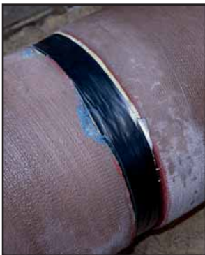
Bild 5: Geschlossener Spalt im Bereich der BLS® - Steckmuffen-Verbindung des ZMU-PLUS-Rohres
