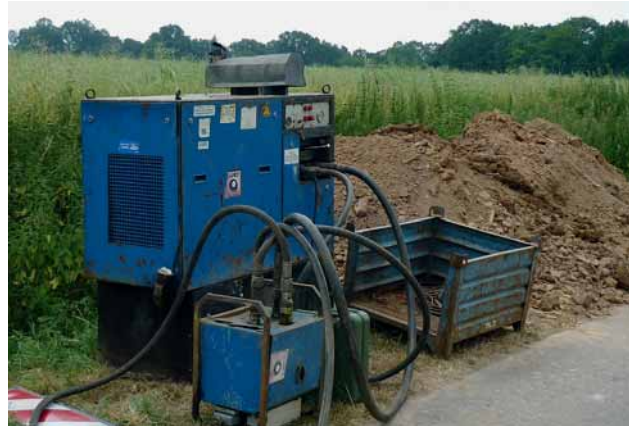
Bild 3: Berstanlage – Hydraulikaggregat zur Steuerung der Berstlaffete
