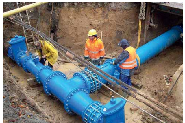
Bild 4: Einbindung der duktilen Gussrohrleitung DN 500 in die Rohrleitung DN 800, ebenfalls aus duktilem Gusseisen
