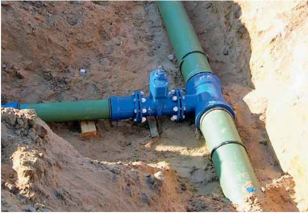
Bild 3: Löschwasserleitung aus duktilen Gussrohren DN 300 mit Abzweig DN 150 für einen Hydrantenanschluss
