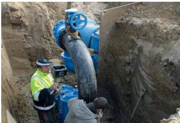
Bild 3: Anschluss einer Interimsleitung
