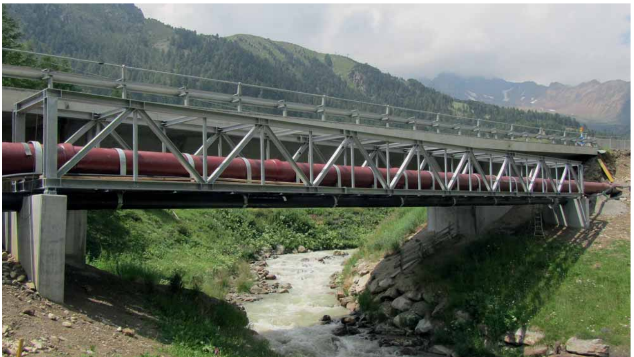
Bild 3: Projekt 1 – Kraftwerk Vernagtsee in Südtirol: Rohrbrücke mit einer Triebwasserleitung DN 700, etwa 25 m lang
