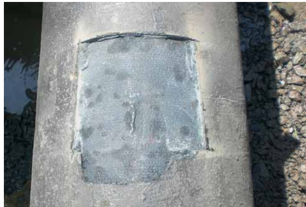
Bild 8: Projekt 3: Duktiles Gussrohr DN 300 – ZM-U mit Epoxidharz-Haftbrücke, kein Zink-Überzug; keinerlei Korrosionsangriffe sichtbar
