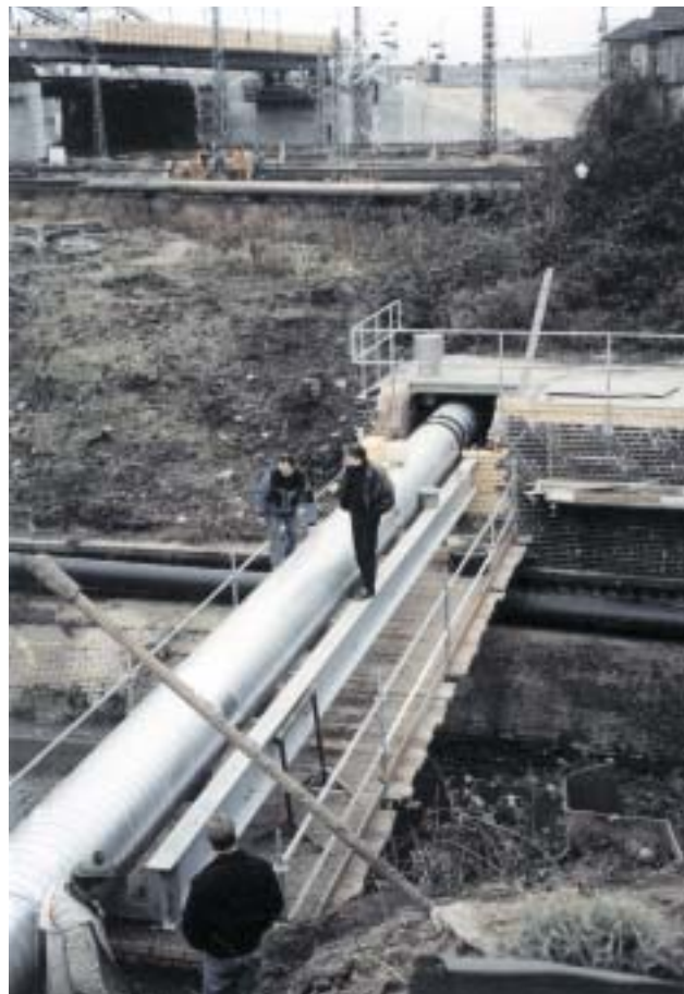
Bild 5: Rohrbrücke mit wärmegeprägten Rohren
