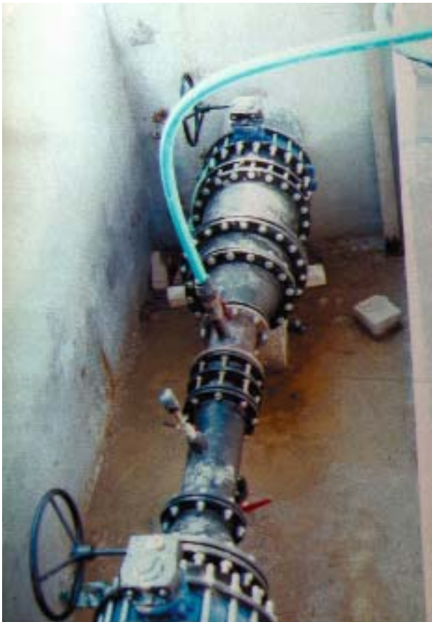
Bild 2: Wasserzählerschacht an der Staatsgrenze
