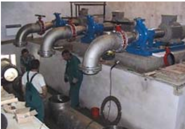
Bild 3: Pumpwerk bei Petrovice
