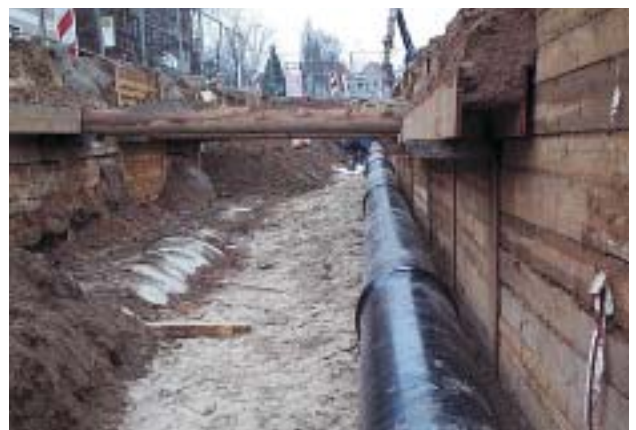
Bild 3: Rohrgraben: links verfüllter Bereich der Kanäle; rechts neu gebaute Hauptwasserleitung DN 500 GGG
