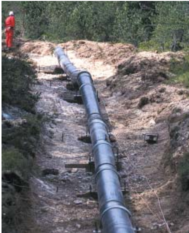
Bild 5: Rohrleitung DN 300 – Hermannstal – eingebaut im Steilhang und mit Erdankern gesichert – wärmeisoliert und beheizt
