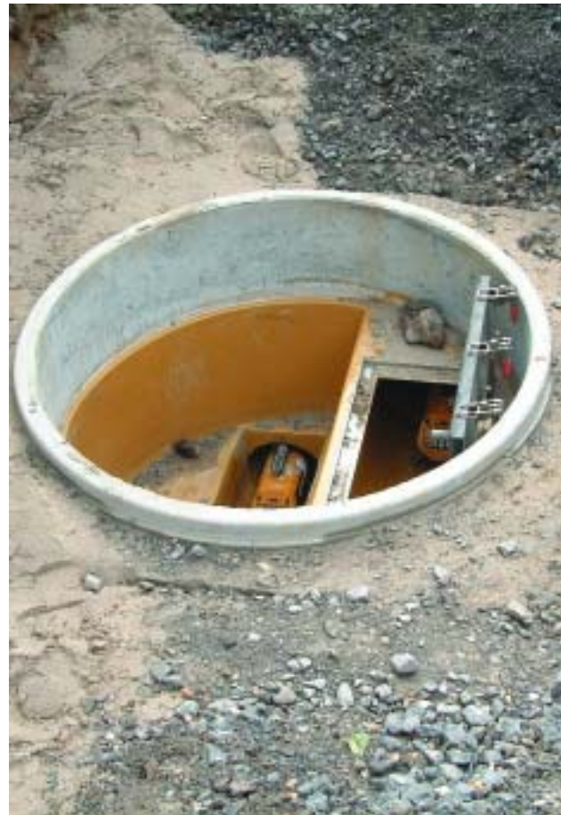
Bild 3: Schacht mit integriertem Schmutz- und Regenwasserkanal
