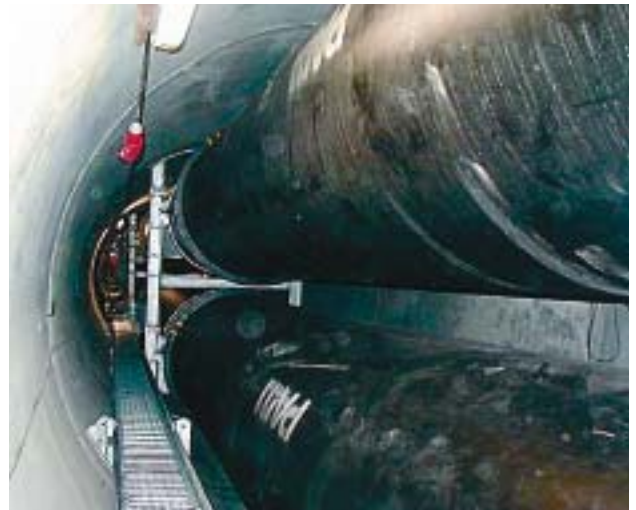
Bild 1: Natürlicher Korrosionsschutz: Der Tunnel wird nach Fertigstellung der Abwasserdruckleitungen mit Grundwasser geflutet. (Foto: FGR/Starosta)
