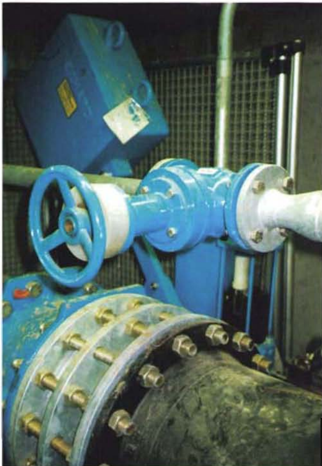
Bild 9: Rohrbruchsicherung im Schachtbauwerk
