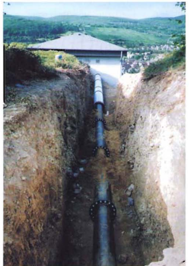
Bild 5: Einspeiseleitung zum Hochbehälter „Tritschkopf“ in den Weinbergen über der Ahr
