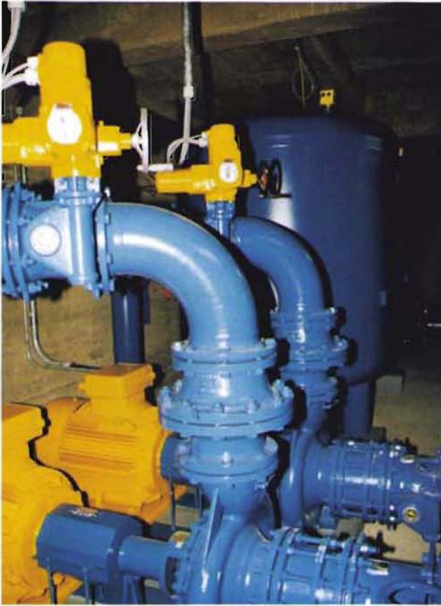
Bild 4: Pumpwerk „Bad Neuenahr“ im HB Wachtberg
