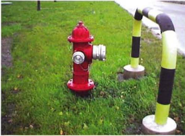
Bild 6: Einer von 250 Hydranten
