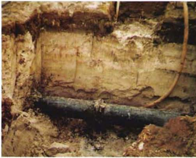
Bild 2: Freigelegte Graugußleitung aus dem Jahre 1938
