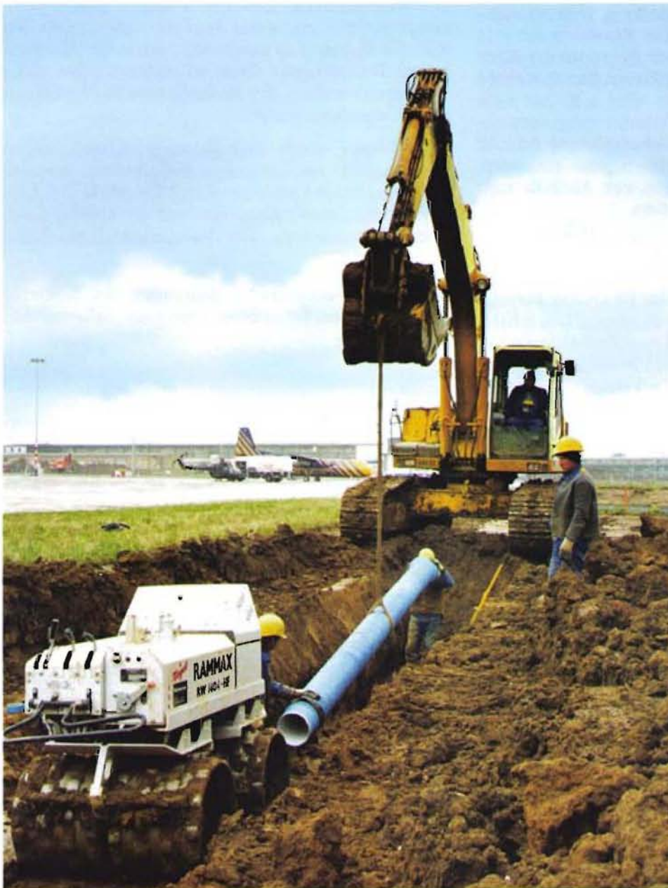
Bild 2: Verlegung der duktilen Gußrohre direkt neben der Rollbahn. Die Verlegezeiträume wurden in Abhängigkeit vom Flugbetrieb vorgegeben.
