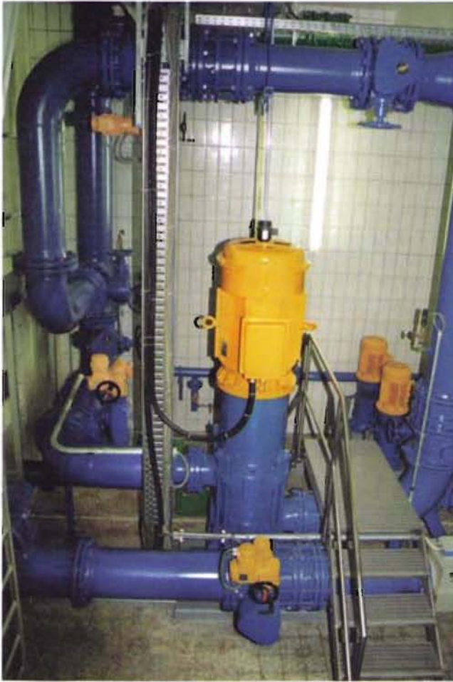
Bild 6: Rückwärtslaufende Kreiselpumpe als Turbine im Hochbehälter „Tritschkopf“
