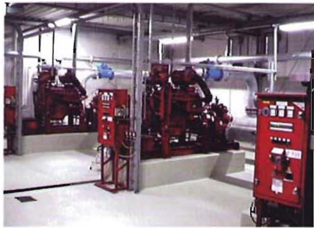
Bild 4: Eine der Pumpstationen
