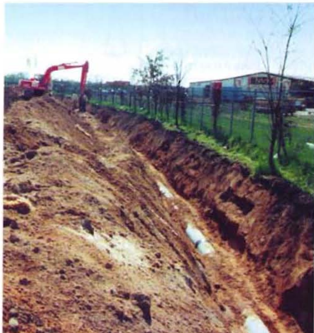
Bild 2: Teilstück der Rohrleitung
