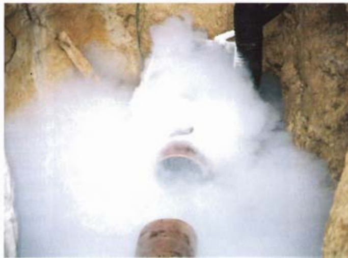
Vereiste Leitung nach dem Herausschneiden eines Schadstücks
