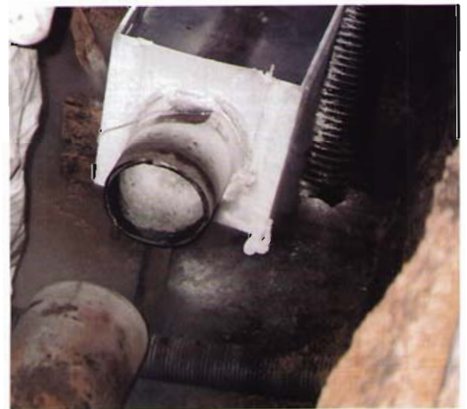
Bild 6: Deutlich sichtbare Eisplombe nach der Rohrtrennung
