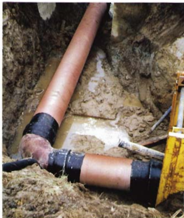
Bild 7: Detail der Löschwasserleitung
