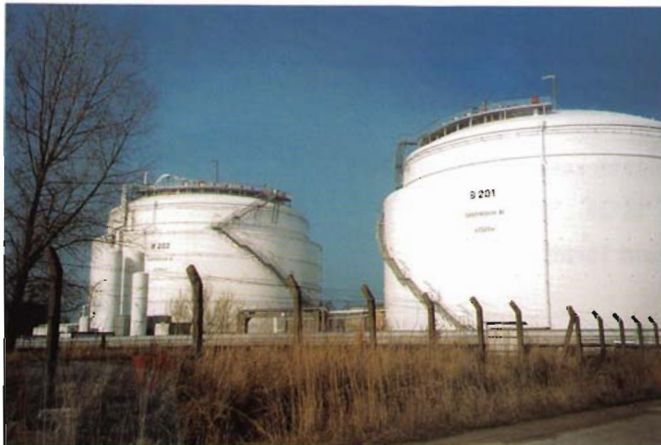
Bild 2: Großtanks im Terminal Rostock
