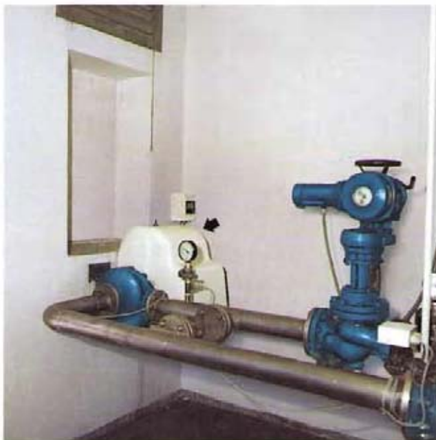
Bild 7: Kleinstturbine in einem alten Hochbehälter
