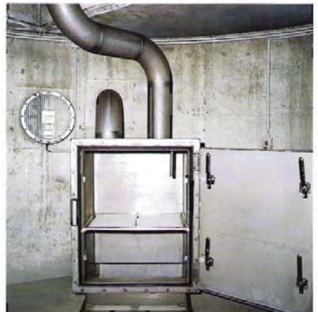
Bild 13: Luftkontrollschacht mit Filter und Meßfühler
