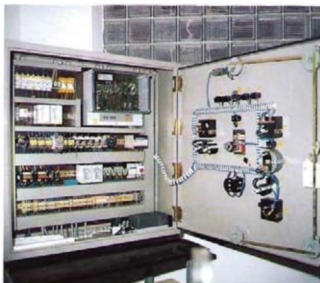
Bild 2: Schaltschrank in 24 V = Technik, Eigenbau
