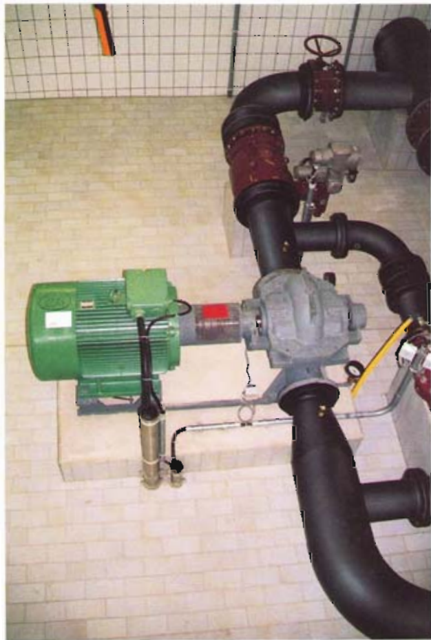
Bild 8: Regelstation mit integrierter Turbine
