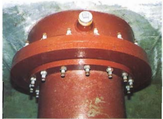
Bild 8: Mantelrohr und Stutzen, mit Dichtflansch bzw. Stopfen verschlossen
