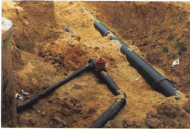
Bild 3: Anschlußleitung Brunnen 6 (links), Entleerung DN 250 (Mitte) und Laufleitung DN 500 von Brunnen 1-5 (rechts)
