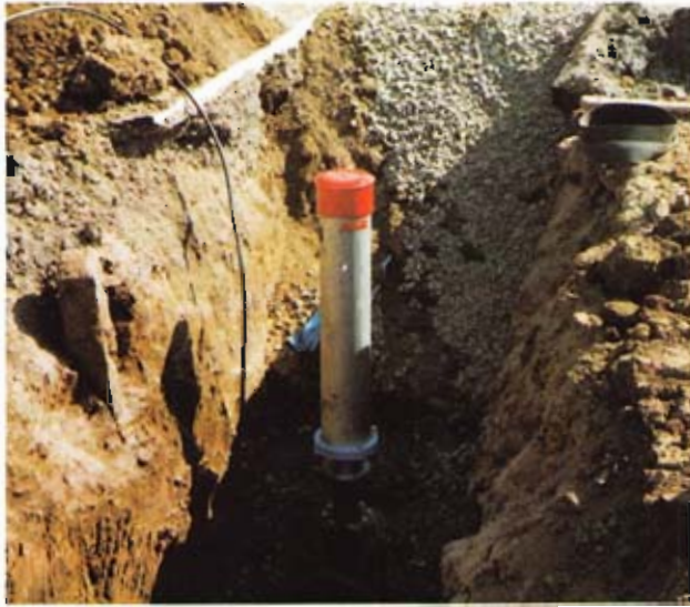
Bild 3: Künstlicher Hochpunkt mit automatischer Entlüftung
