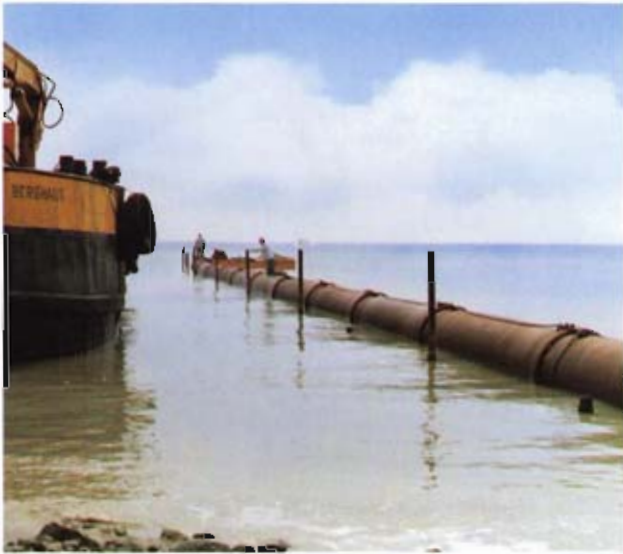
Bild 10: Leitung in der vorgesehenen Trasse
