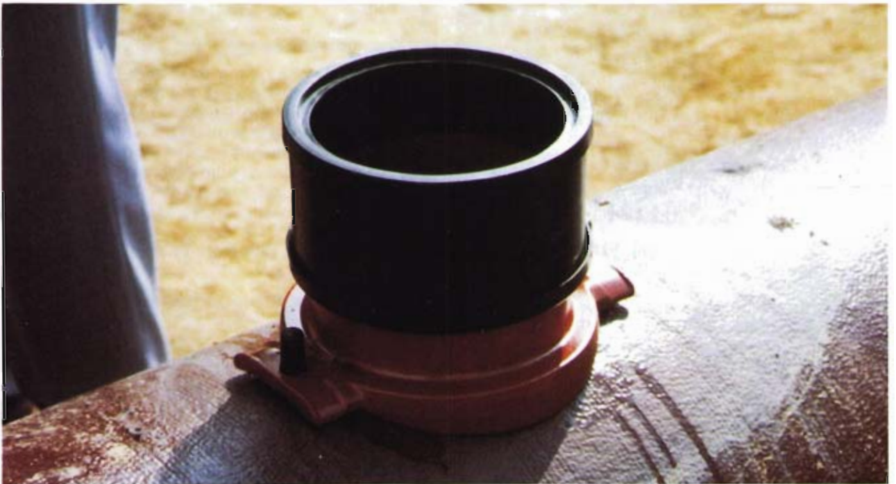
Bild 8 bis 10: Die Arbeitgänge bei der Herstellung eines Hausanschlusses: Anschlußloch und Schraubenlöcher bohren, Dichtung einsetzen, Sattelstück (hier mit Übergangsstück) aufschrauben
