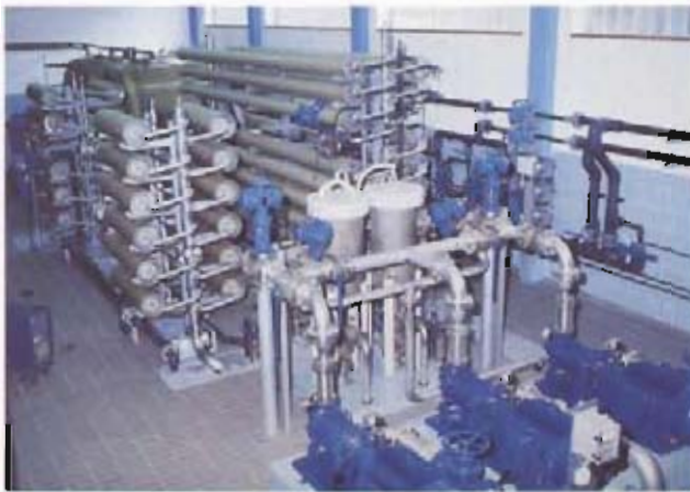
Bild 3: Umkehr-Osmose-Anlage im Wasserwerk Rhume
