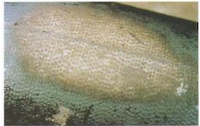
Bild 21: Aufgrabung Beuren Aussehen der Rohroberfläche nach Entfernen der Deckbeschichtung und – stellenweise – der Zinkkorrosionsprodukte
