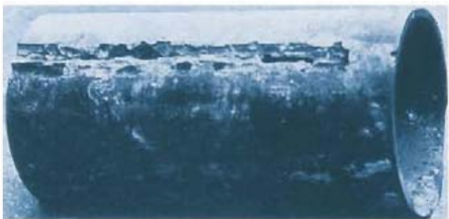
Bild 6: Lokalisierung der Korrosion entlang einer Kratzspur; Graugußrohr DN 200 mit Teerung
