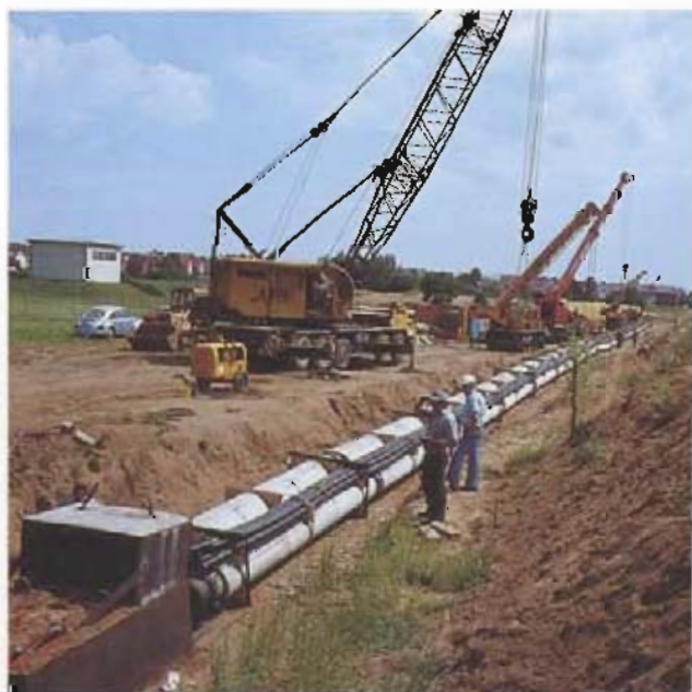
Bild 6: Düker mit Kabelleerrohren
