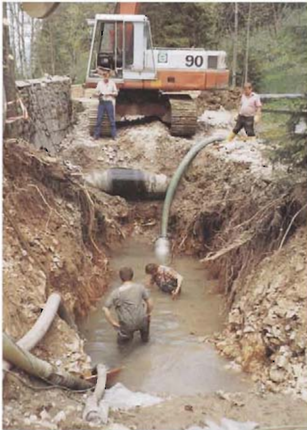
Bild 6: Schwierige Bauverhältnisse durch starken Grundwassereinbruch
