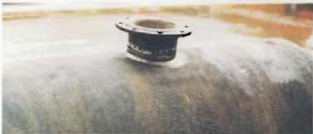
Bild 6: Hauptrohr DN 900 aus duktilem Gußeisen mit einem Abgang (F-Stück) DN 150 aus duktilem Gußeisen
