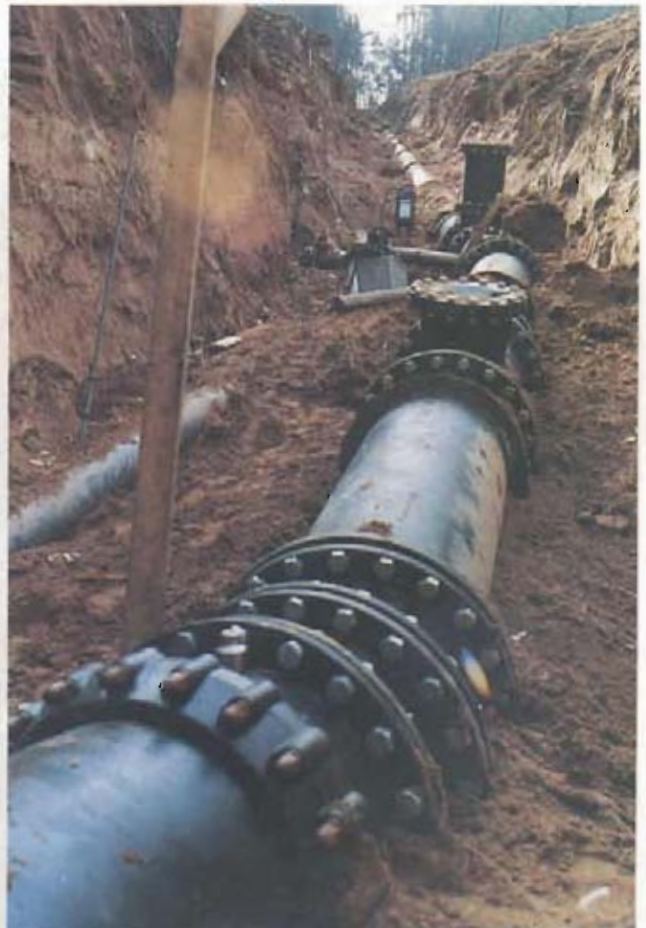
Bild 4: Rohrverbindungen und Wartungsöffnungen der Abwasserleitung
