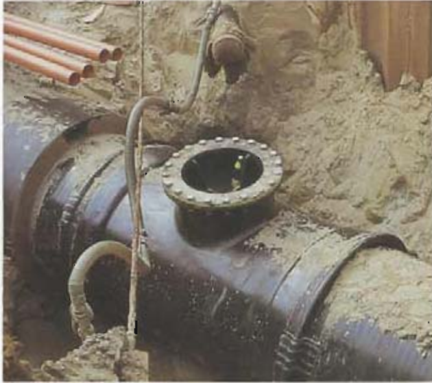
Bild 4: Doppelmuffenstück DN 1200 mit eingelassenem Deckel DN 600
