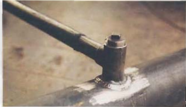
Bild 7: Hauptrohr DN 150 aus duktilem Gußeisen mit T-Stück 1 1/2" x 1 1/2" aus Stahl und Hausanschlußleitung 1 1/2" aus Stahl
