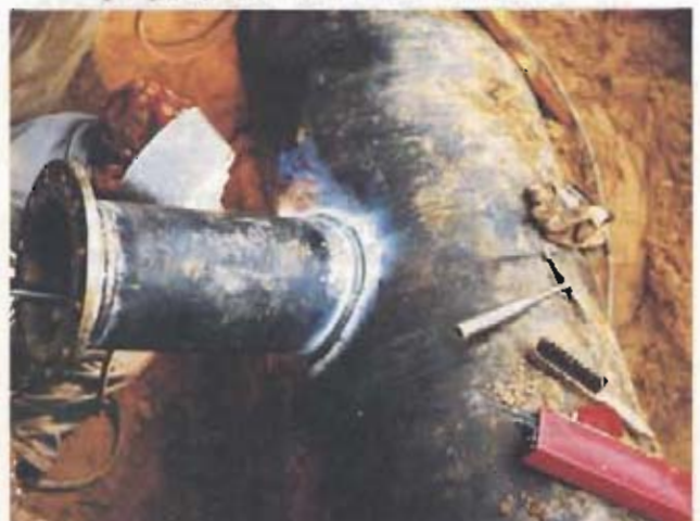
Bild 4: Hauptrohr DN 600 aus duktilem Gußeisen mit Abgang DN 250 aus duktilem Gußeisen
