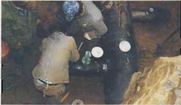
Bild 5: Hauptrohr DN 500 aus duktilem Gußeisen mit zwei Abgängen DN 200 aus duktilem Gußeisen
