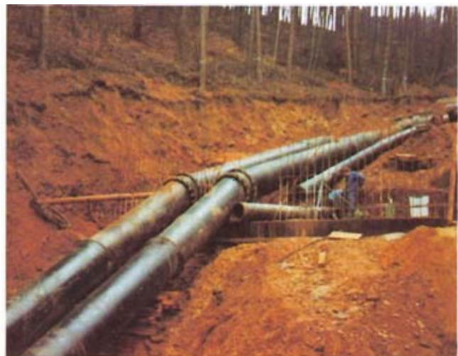
Bild 6: Zu- und Ablaufleitungen DN 800 zum Hochbehälter bzw. zur Aufbereitungsanlage
