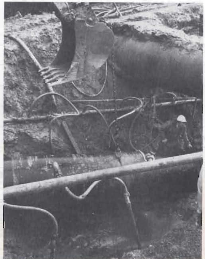
Bild 6 Nette-Dükerung. Das oben rechts sichtbare Rohr DN 1400 konnte zweimal das Hochwasser der Nette nicht aufnehmen, so daß die Baugrube überflutet wurde und schließlich für mehrere Monate stillgelegt werden mußte.
