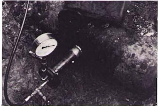
Bild 7: Angeschweißter Abgang NW 80, der an ein Gußrohr mit Wasserinnendruck angeschweißt wurde, während der Druckprobe bei 24 bar
