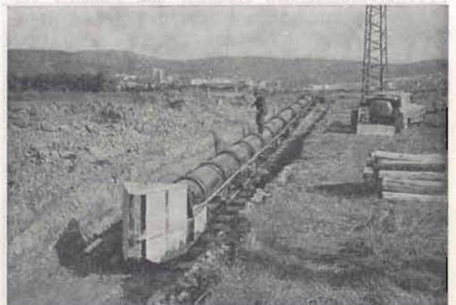
Bild 9: Abwasserdüker aus duktilen Gußrohren NW 700 mit TYTON-Kupplungen
