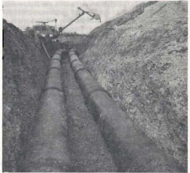
Bild 8: Gußrohrleitung NW 600 mit TYTON-Muffen
