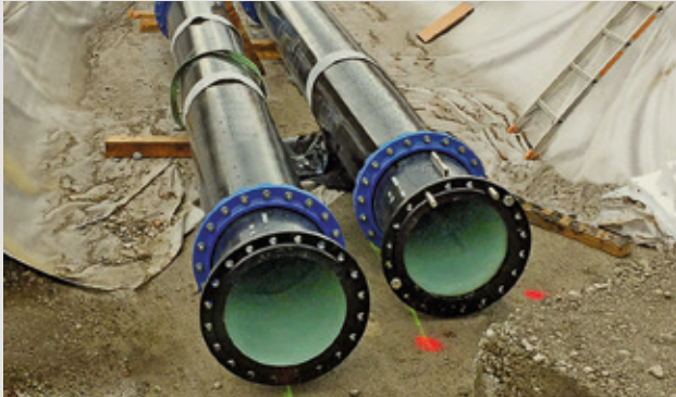
Double pipeline at ARA Werdhölzli, Zürich, DN 600, PFA 25 bar.
