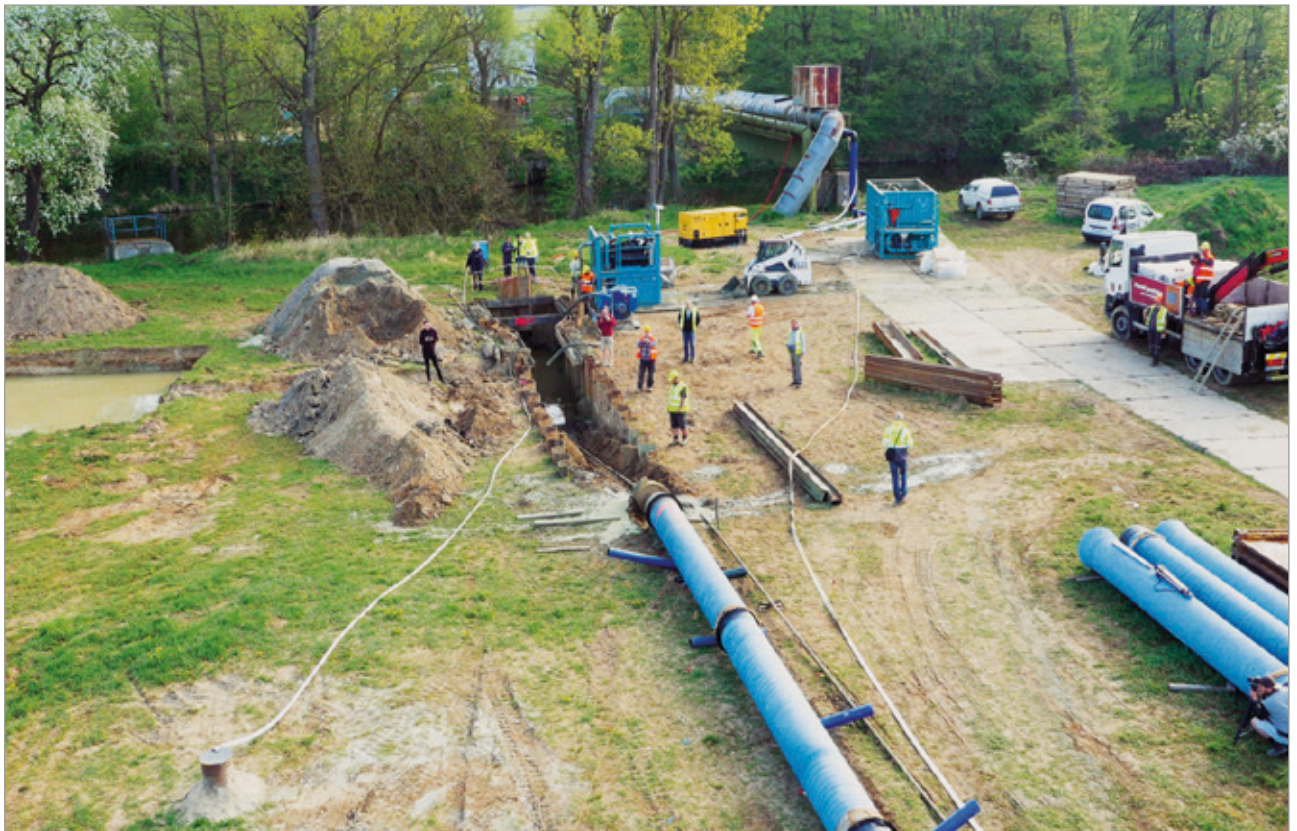
Im Hintergrund: Die in die Jahre gekommene, über die Nežárka-Brücke geführte Trinkwasserleitung; Bildmitte: Startgrube und der zum Einzug bereit liegende fertige Rohrstrang.
