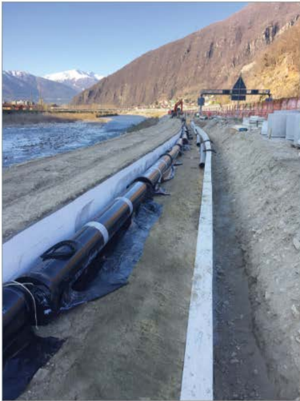
Leitungstrasse der Trinkwasserleitung zwischen dem Fluss Ticino im Kanton Tessin (Schweiz) und der Autobahn A2.
