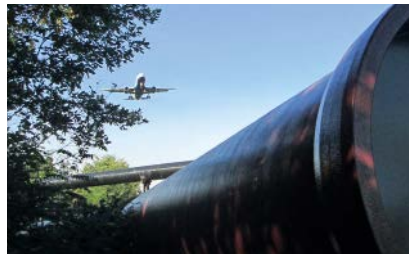
Interimsleitung in der Nähe des Flughafens Berlin-Tegel
