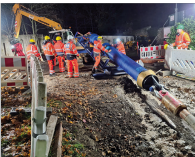
Abb. 10: Rohrmontage in der Nacht. (Quelle: vonRoll hydro (deutschland) gmbh & co kg, Wetzlar)
