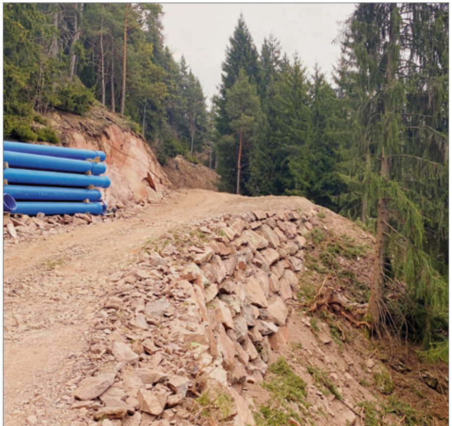
Abb. 7: Für die Zufahrtswege wurden ca. 10.000 m 3 Fels herausgesprengt und zahlreiche Stützmauern errichtet.
