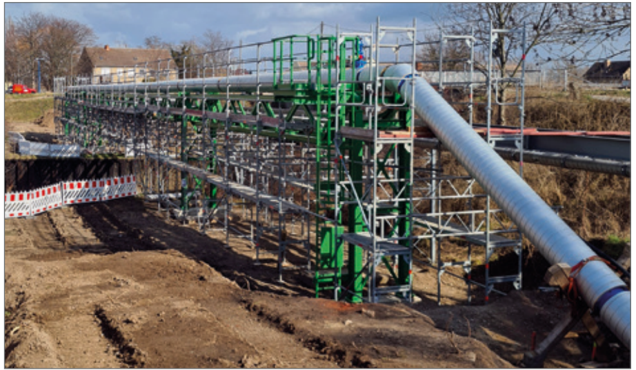
Abb. 13: Rohrbrücke mit WKG Rohren DN 400 BLS® und Wickelfalz-Mantelrohr. (Quelle: vonRoll hydro (deutschland) gmbh & co kg, Wetzlar)
