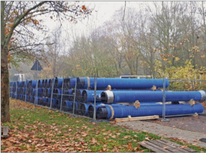
Abb. 6: Duktile Gussrohre DN 500 mit BLS®-Verbindung und Zementmörtelumhüllung. (Quelle: vonRoll hydro (deutschland) gmbh & co kg, Wetzlar)
