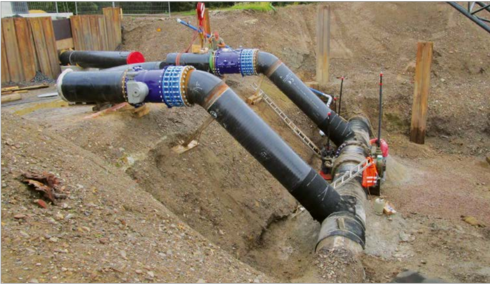
Bild 1: Zu- und Ablaufleitung DN 800 mit emaillierten Absperrklappen DN 800 aus duktilem Gusseisen zur UV Anlage im Wasserwerk Halingen der WWWW
