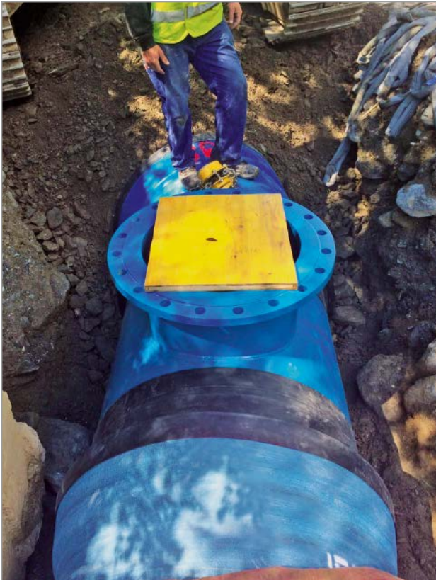
Bild 9: Eines von drei Mannlöchern im Verlauf der Kraftwerksleitung
