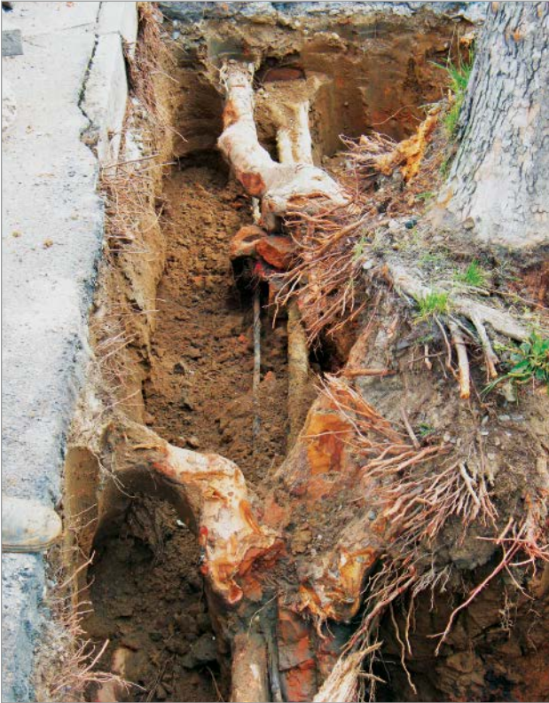
Bild 1: Starkwurzeln im Leitungsgraben einer Telekommunikationsleitung
