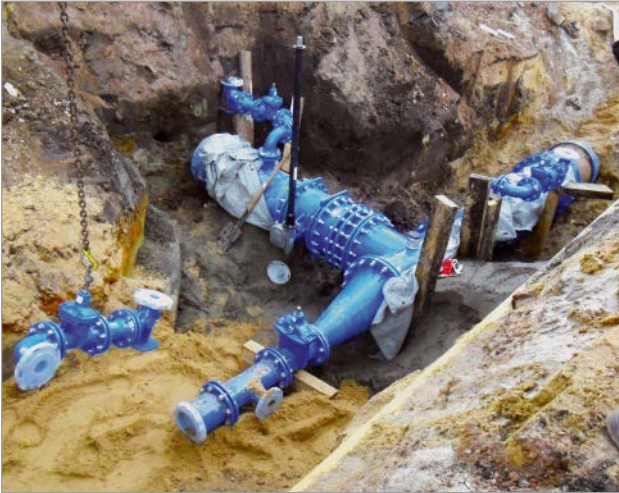
Bild 3: Armaturen und Formstücke aus duktilem Gusseisen im Leitungsbereich DN 150 – Wiener Straße
