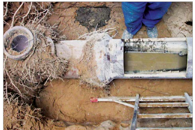
Bild 6: Wurzeln in einer Tiefe von 7 m, die aufgrund der guten Sauerstoffversorgung bis in diese Tiefe gewachsen sind Quelle: Schmiedener, H.
