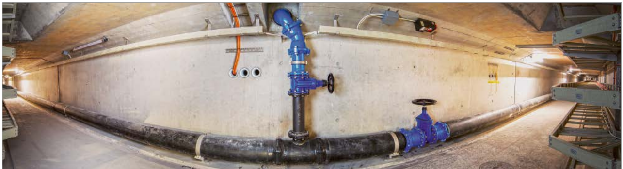
Bild 4: Panoramabild der Löschwasserleitung im Werkleitungskanal mit Seitenabgang und Streckenschieber
