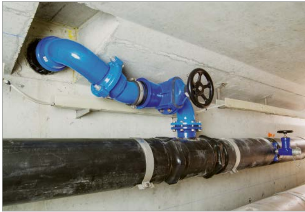
Bild 10: Stichleitung DN 125 zu den Hydranten-Nischen im Hüllrohr (vorn im Bild) und Spülstutzen mit Anbohrschieber auf der Hauptleitung (im Bildhintergrund)
