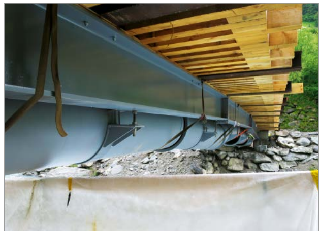
Bild 8: Blick unter die Fußgängerbrücke mit den gebogenen Stahlträgern – die duktilen Gussrohre folgen dem Verlauf der Krümmung
