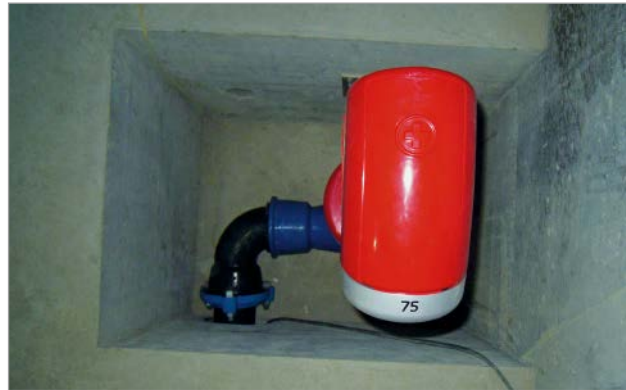
Bild 13: Eingeengte Platzverhältnisse für die Installation der Hydranten
