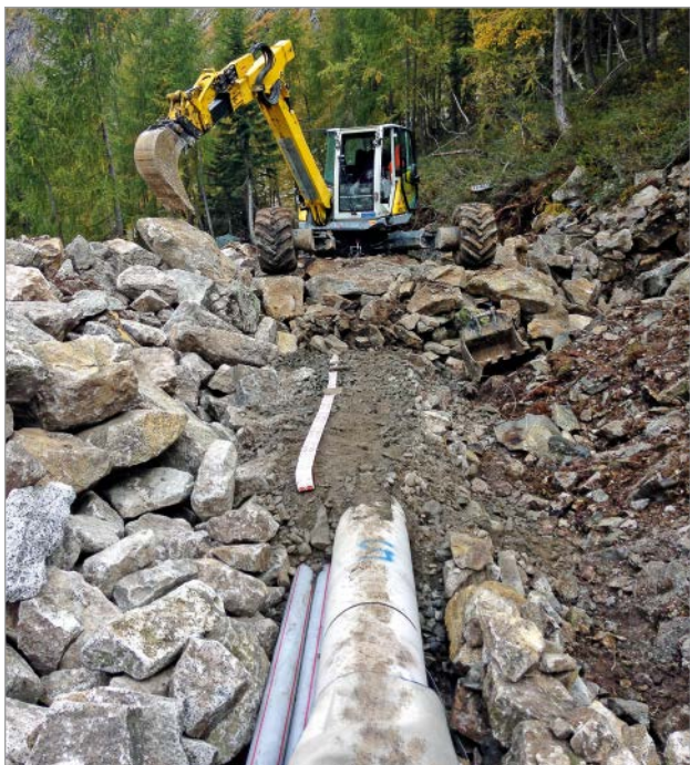
Bild 12: Druckleitung ECOPUR mit parallel geführten Leerrohren für die Versorgungs- und Steuerungskabel
