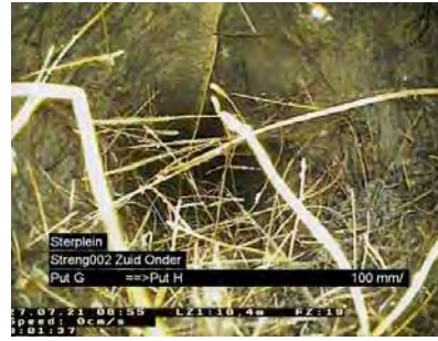
Abb. 10: Beispiel für in den Kanal hineinwachsende Haarwurzeln
