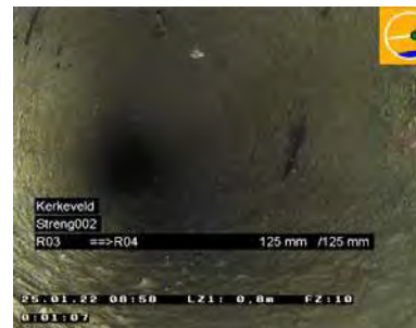
Abb. 9: Beispiel für Sedimente auf der gesamten Kanaloberfläche
