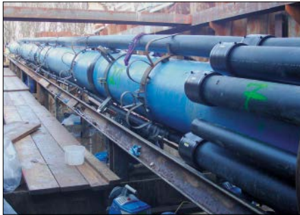
Bild 22.51: Abwasserleitung – geführte Rollenschellen
