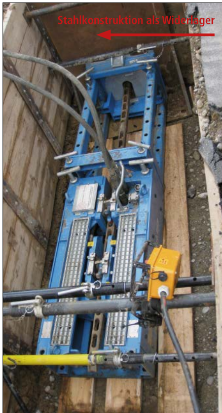
Bild 22.17: Zugmaschine und Widerlager
